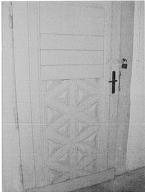
Abb. 18: Eine nach den Entwürfen des Büro Poelzig ausgeführte Tür im Kellergeschoss. Der obere Bereich, wohl ursprünglich verglast, wurde nachträglich mit Brettern verschlagen. Foto: Zalewski
